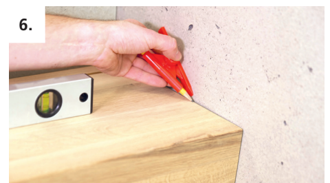
6. Auf der Baustelle Treppentritte anreissen und, wo nötig, an das Wandprofil anpassen.
