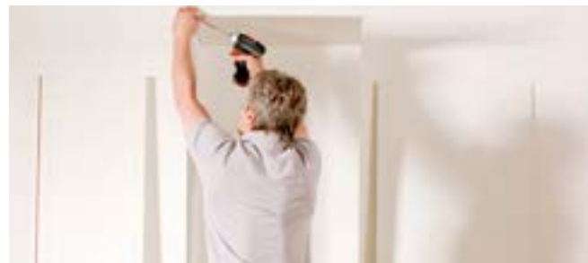
Akkuschauber bereithalten und vordere Ecke verschrauben. So sind auch Einmannmontagen problemlos möglich.
